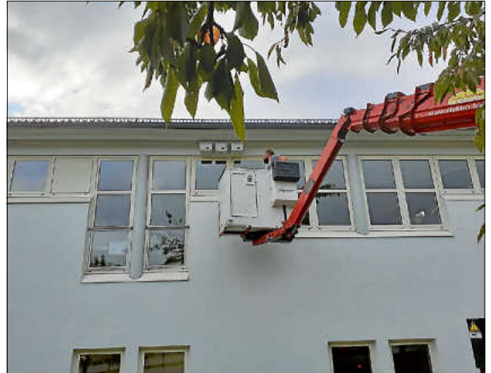
Hubsteiger der Firma Elektro Lörcher im Einsatz beim Anbringen der Mauerseglerkästen Foto: Gerald Langer
