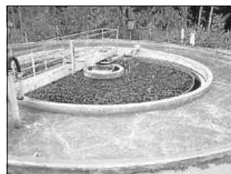
Das Landratsamt bietet Besichtigungen von Kläranlagen an.
